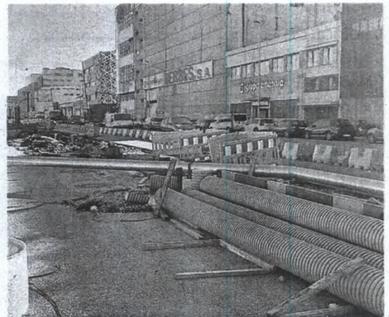
Obras del carril bici que está realizando en la fachada del Berbés.
